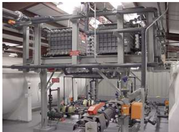
Figura 7: Foto sistema de baterías redox.
